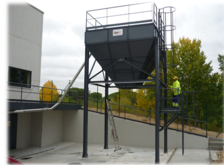
Sistema de almacenamiento de Fango Deshidratado
